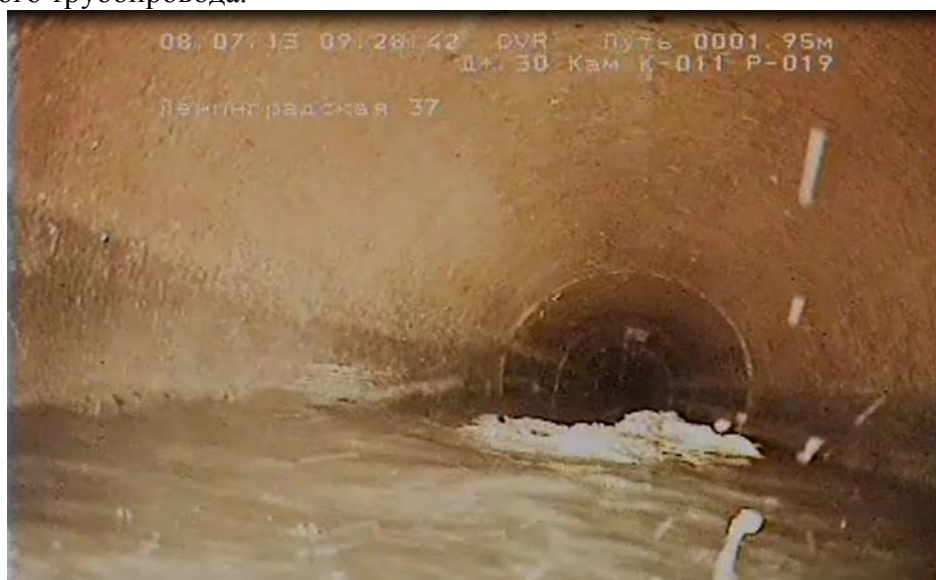
Рисунок 10 – Пример результата телеметрического обследования канализационного трубопровода
